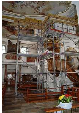
Ein Gerüst schützt die Putzdecke mit den Gemälden vor Erschütterungen, die durch die Arbeiten ausgelöst werden könnten.
